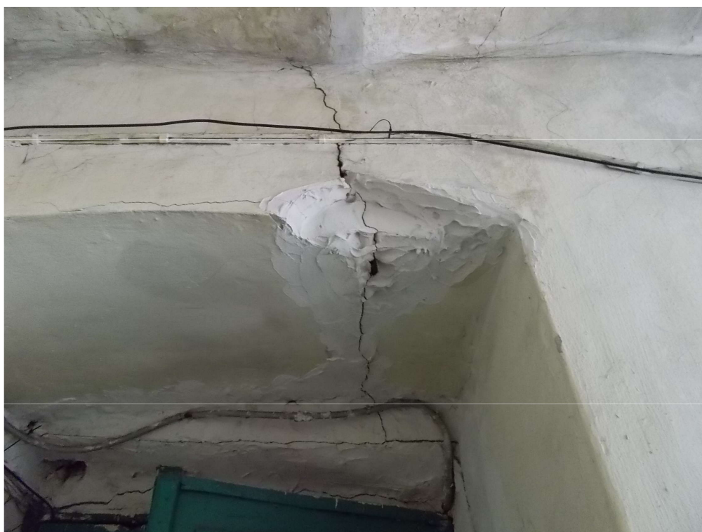
Рисунок 2.5.22 – Трещина в кирпичной стене по оси 4/Б-В шириной раскрытия до 15мм
