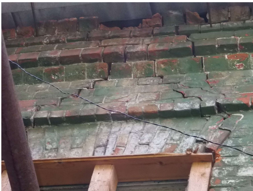
Рисунок 2.5.19 – Трещины в кирпичной стене по оси Д/2-4 шириной раскрытия до 30мм
