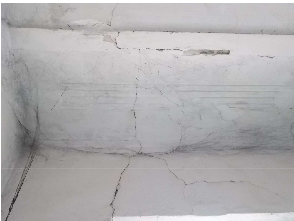
Рисунок 2.5.32 – Трещина в кирпичном сводике перекрытия
