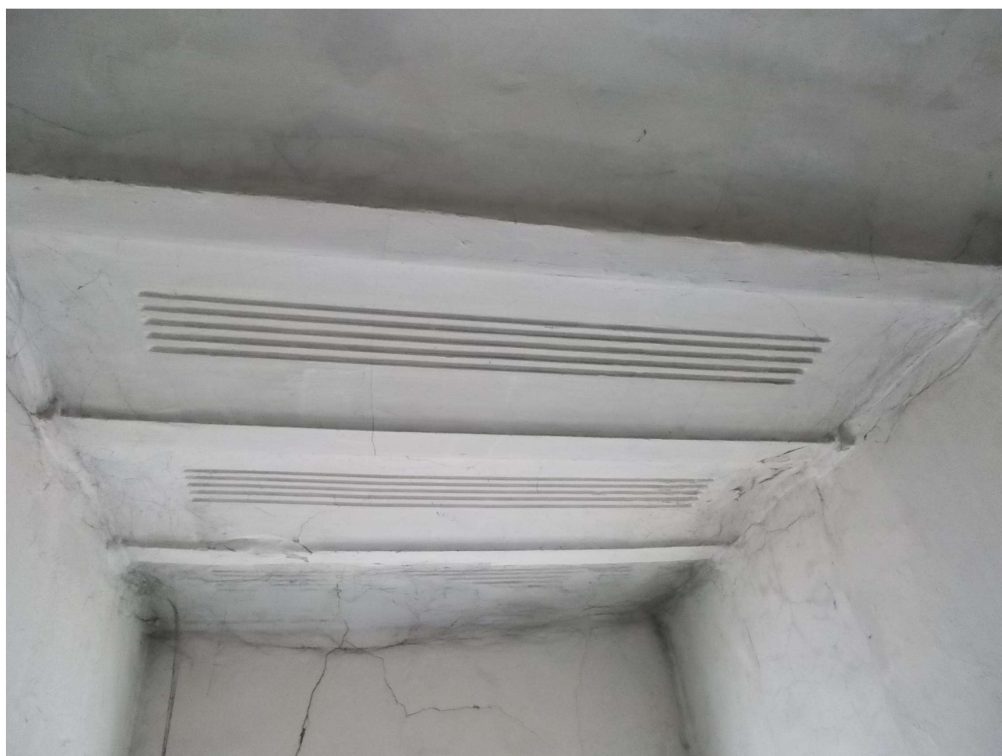
Рисунок 2.5.31 – Прогиб балки перекрытия до 30мм
