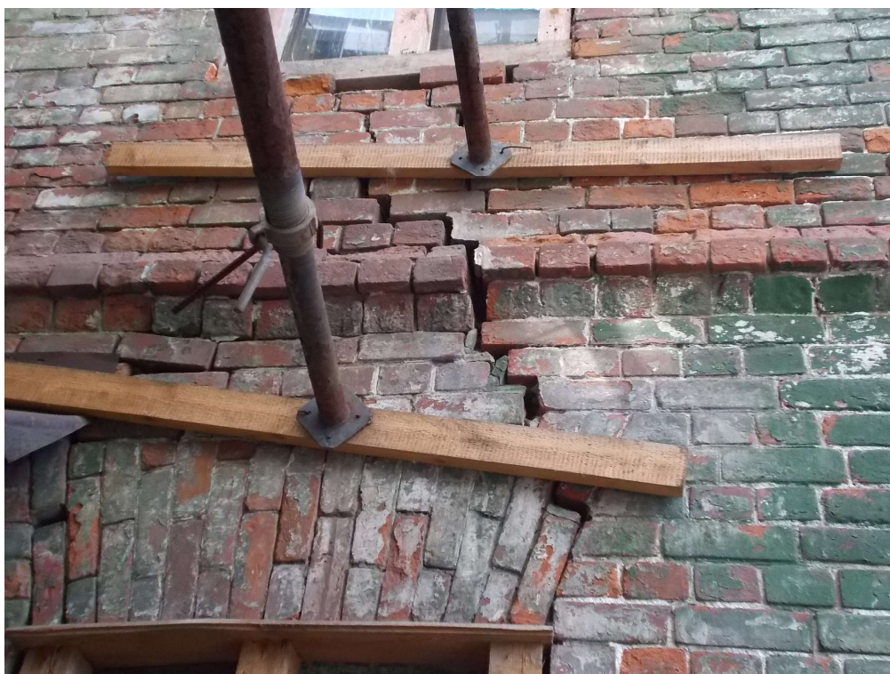
Рисунок 2.5.18 – Трещина в кирпичной стене по оси Д/2-4 шириной раскрытия до 35мм
