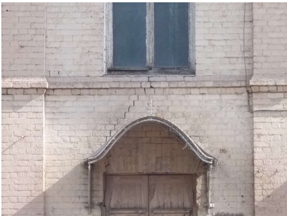
Рисунок 2.5.15 – Трещины в кирпичной стене по оси А/3-4 шириной раскрытия до 15мм
