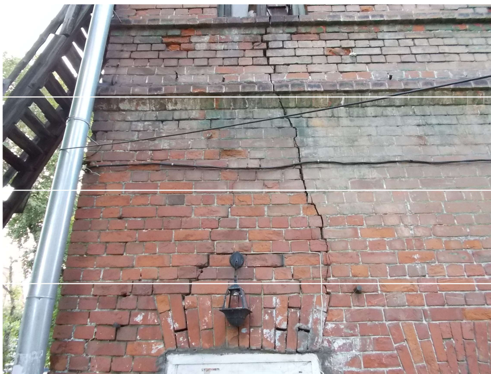
Рисунок 2.5.20 – Трещины в кирпичной стене по оси 1/И-Ж шириной раскрытия до 30мм
