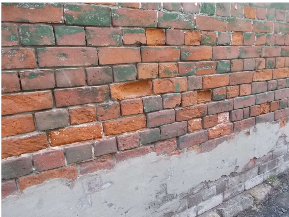
Рисунок 2.5.25 – Морозная деструкция кирпичной кладки отдельных участков фасадов
