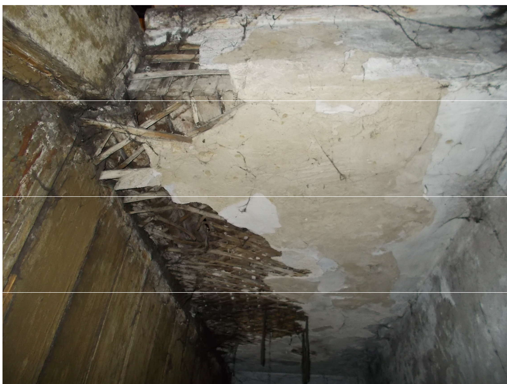
Рисунок 2.5.30 – Разрушение штукатурного слоя и дрени отделки потолка лестничной площадки
