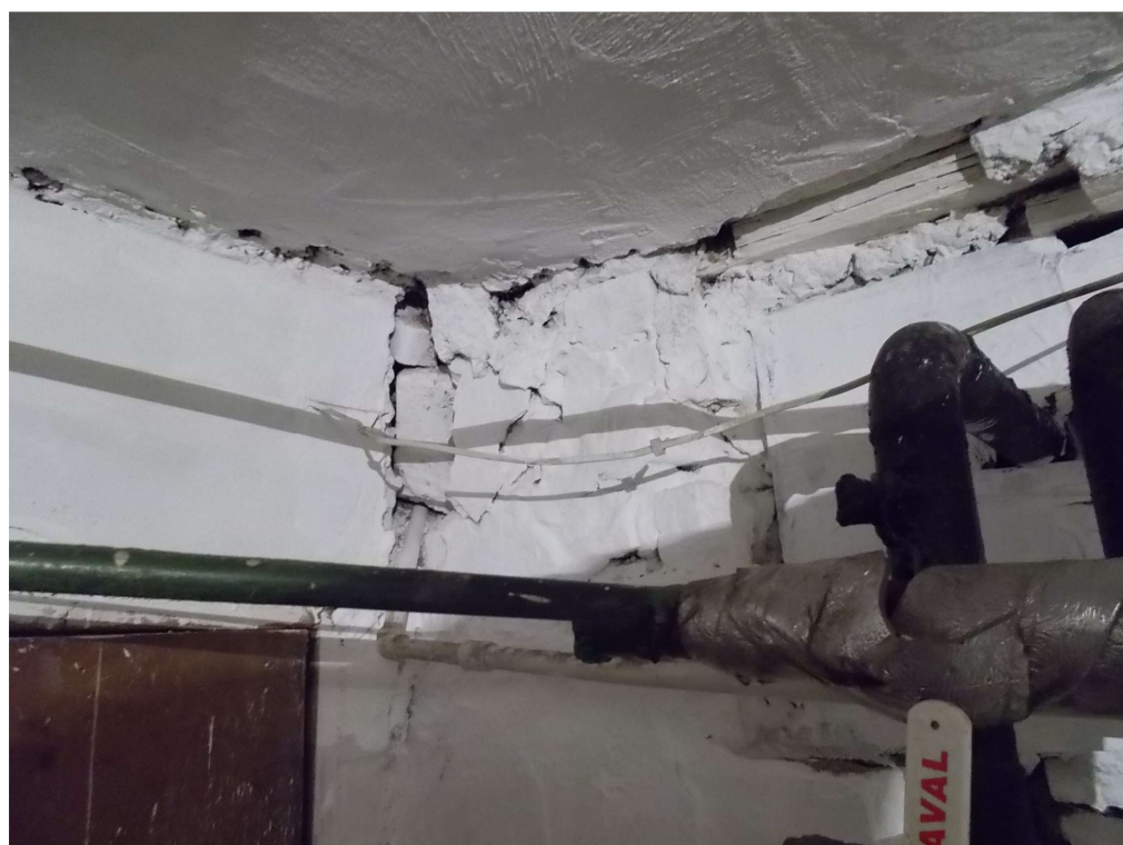
Рисунок 2.5.14 – Разрушен участок кирпичной кладки стены по оси И/4-3
