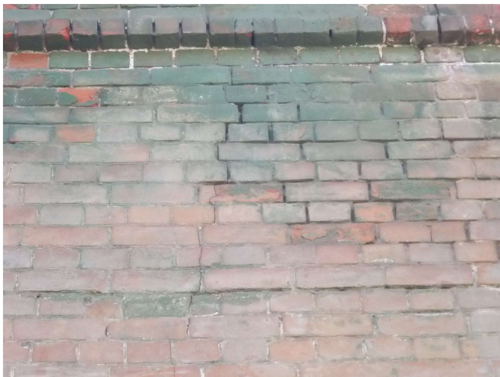
Рисунок 2.5.17 – Трещина в кирпичной стене по оси 2/В-Г шириной раскрытия до 15мм
