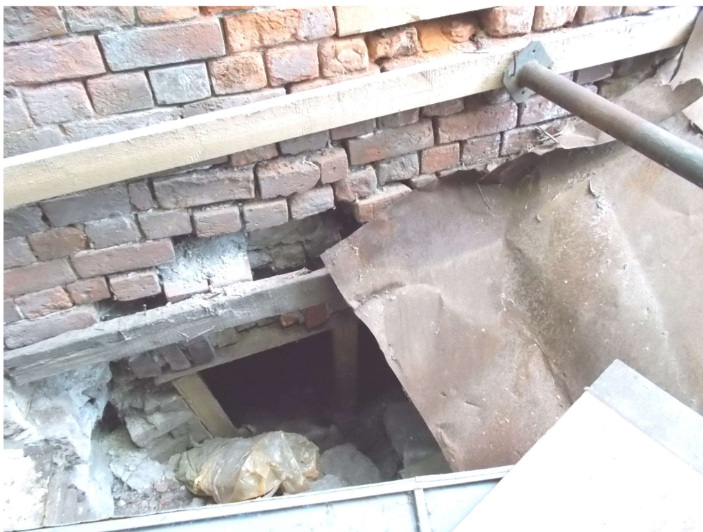
Рисунок 2.5.23 – Разрушение участка стены по оси Д/4-3 и проём входа в подвал
