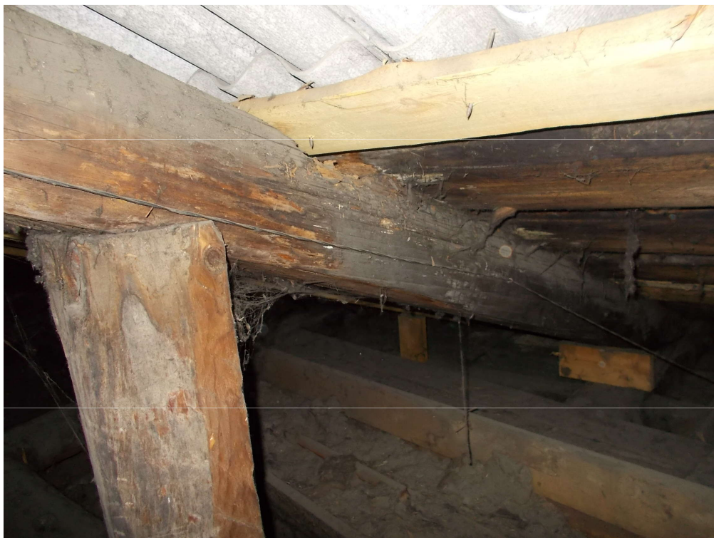
Рисунок 2.5.34 – Гнилостные повреждения стропил по оси Ж-И/6
