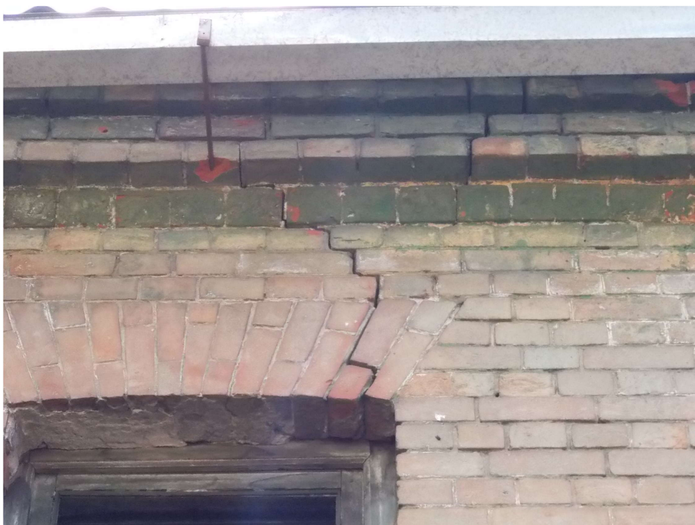
Рисунок 2.5.21 – Трещина в кирпичной стене по оси 1/И-Ж шириной раскрытия до 20мм
