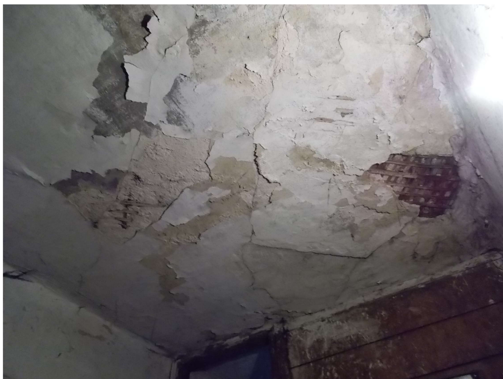
Рисунок 2.5.29 – Разрушение штукатурного слоя отделки потолка 2 этажа
