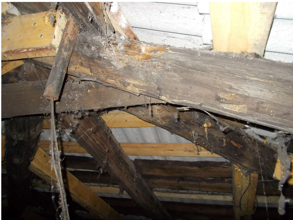
Рисунок 2.5.33 – Гнилостные повреждения стропил по оси Ж/6
